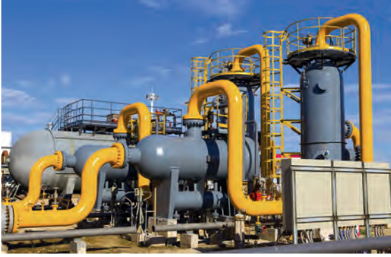
Görsel 4.5.3: Doğal gaz işleme tesisi
